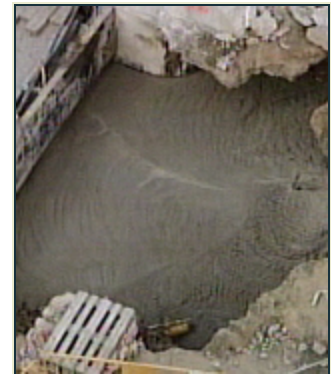
El socavón tiene tres metros de profundidad
