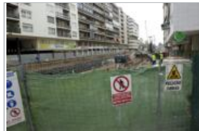
La zona de obras en República Argentina ha invadido parte del carril de emergencias por trabajos de cimentación. RAÚL DOBLADO
